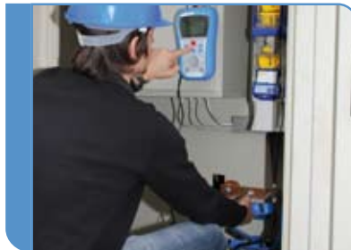
Zwei-Zangenmethode zum Prüfen des Bodenwiderstands für das TN-System.
