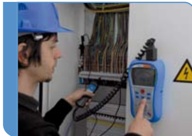
Isolationsmessung an Schaltschränken.
