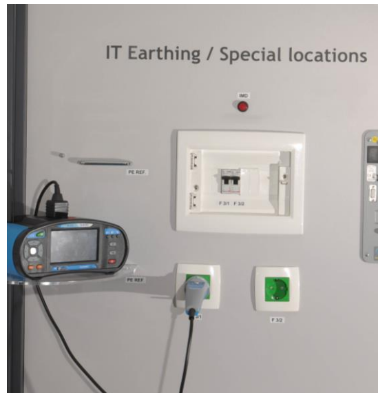
Abbildung 2-4: Messen von Z_{Line} im Application Trainer mit dem Schuko Commander an einem IT System
